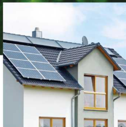
FOTOVOLTICKÉ MODULY A INVERTORY
